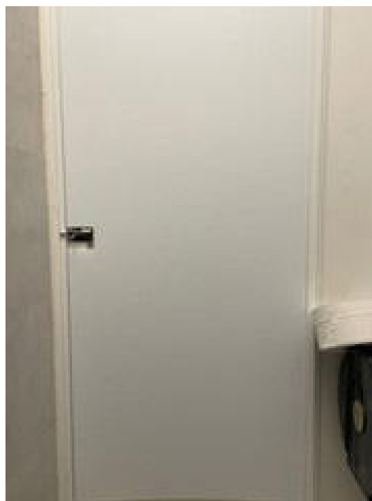
Puerta falsa, con lámina instalada en un baño, 2025. Campus Central, Universidad de Colima, México.
